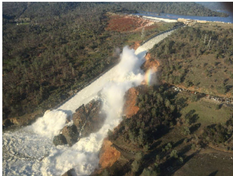
2月11日、緊急放水路が一部決壊した米国カリフォルニア州オロビルダム(写真:提供: William Croyle/California Department of Water Resources/ロイター/アフロ)
