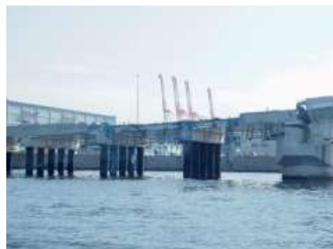
南本牧はま道路の崩壊
