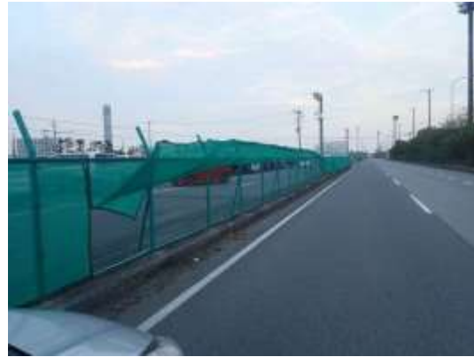
千葉中央ふ頭コンテナターミナル 自動車ヤードフェンス損傷 付近の自動車にチッピング等の損傷可能性あり
