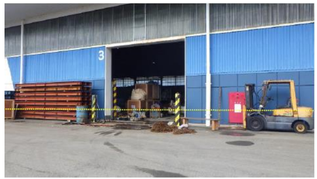
点線の位置(約 1m)の高さまで浸水した上屋
